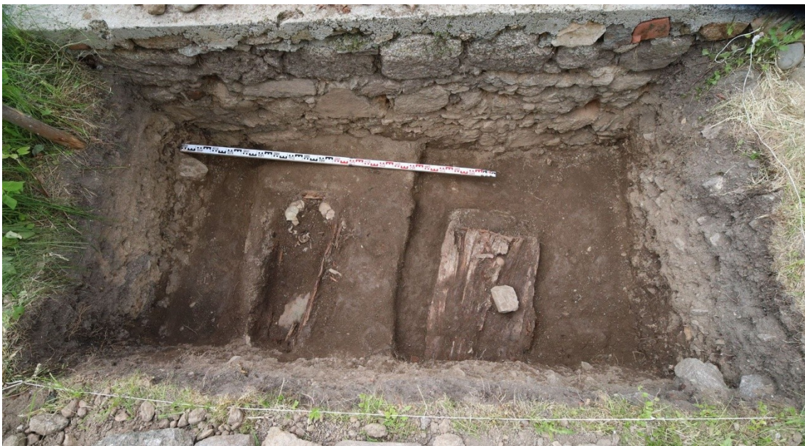
Bečov nad Teplou, odvod dešťových vod a zajištění opěrné zdi pod kostelem sv. Jiří archeologický výzkum
